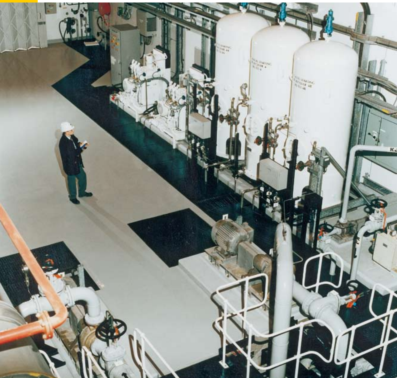
Помещение для загрузки, атомная электростанция Sizewell, Англия
